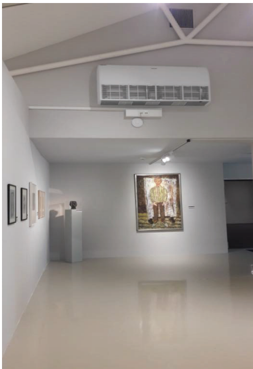
Déli szárny: emeleti kiállítótér klímája
